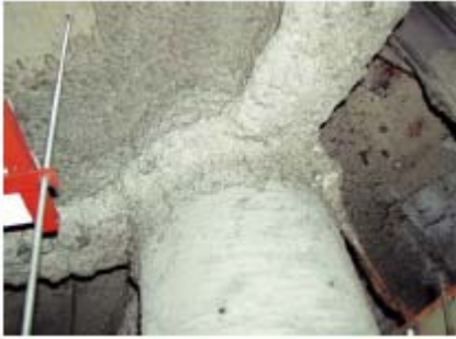
吹付けアスベスト (鉄骨耐火被覆材)
