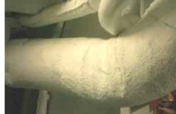
(アスベストクロスを蒸気配管に巻いている)
