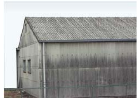
石綿スレート
