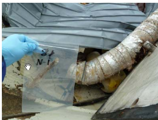
漁船（右写真）で見つかった配管 （内側の層にクリソタイル 85%の保温材）
