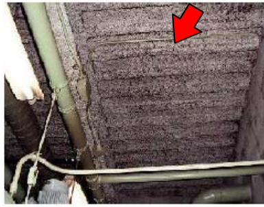
アスベスト含有吹付け ロックウール (天井断熱材)
