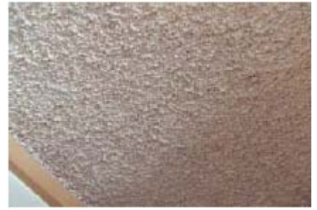
アスベスト含有吹付けパーミ キュライト (ひる石) (天井)
