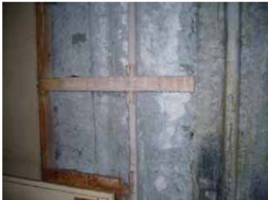
(居住区壁裏の吹き付けアスベスト材)
