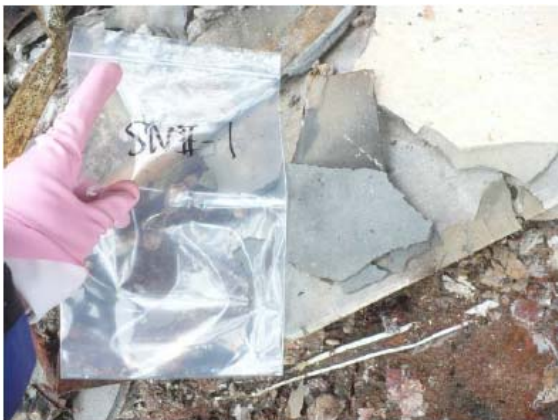
アスベスト（クリソタイル）5%含有のスレート
