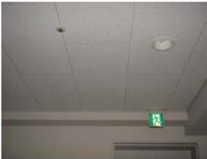
アスベスト含有石膏ボード (天井)
