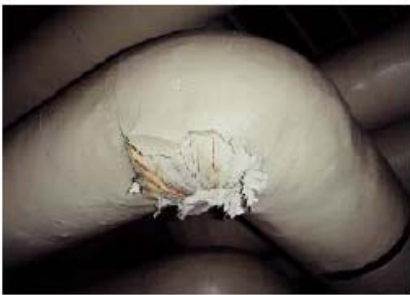
保温材 (配管エルボ)
