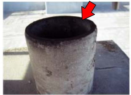
煙突用アスベスト断熱材 (躯体内部に打ち込まれている)
